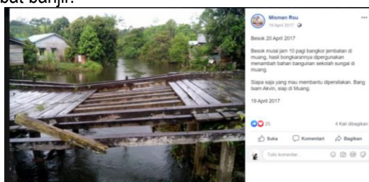
Gambar 2. Potrait puing-puing Jembatan yang rubuh dan direncanakan akan digunakan sebagai bahan konstruksi dalam membangun gedung-gedung arsitektur (Sumber : Facebook, 2023)
