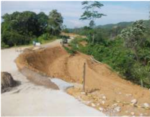
Situasi Lokasi Longsoran
