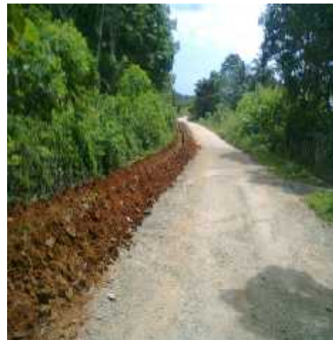
Gambar 3.2 Kondisi Jalan Daerah Penelitian
