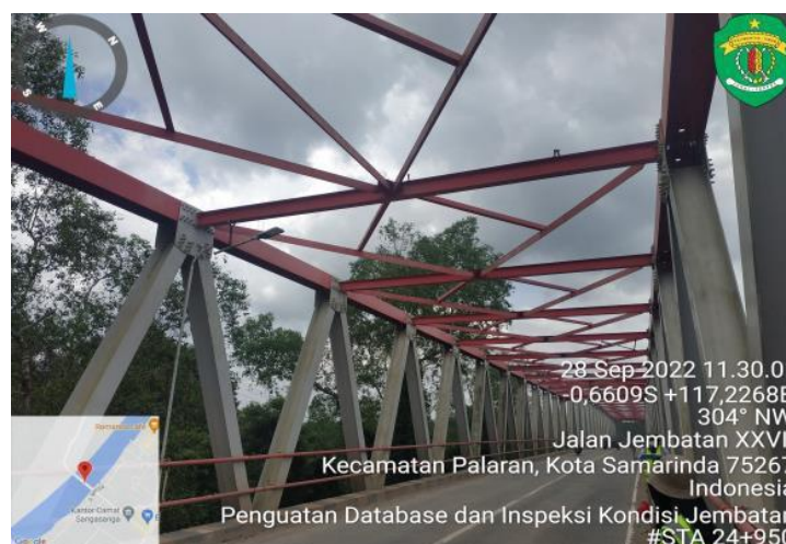
Gambar 6. TiangLampu Penerangan Patah
