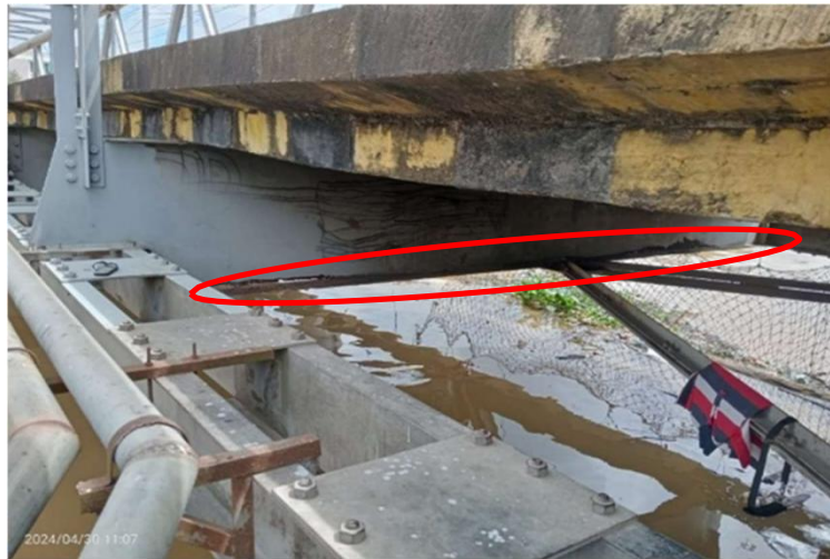
Gambar 2 Kerusakan Girder akibat korosi
